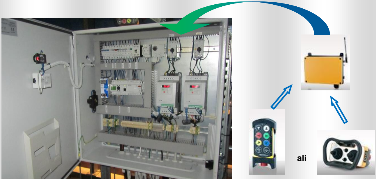
Notranji izgled glavne krmilne omare in brezžično upravljanje, FALUN 2013.
